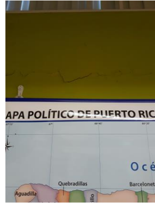
Condición típica en pared no estructural, 3er piso
