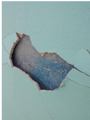
Empañetado por colapsar
