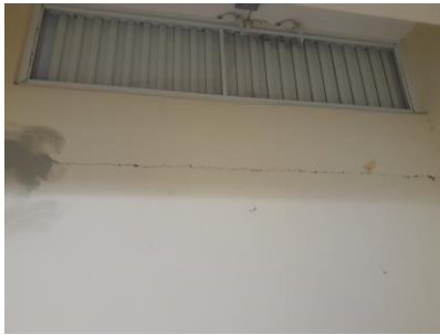
Condición típica en pared no estructural, 3er piso
