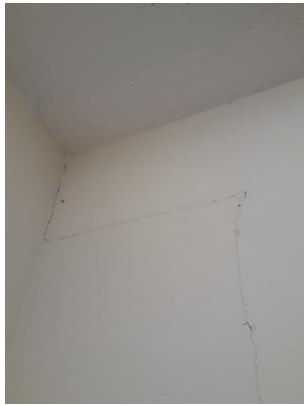
Grieta en pared no estructural
