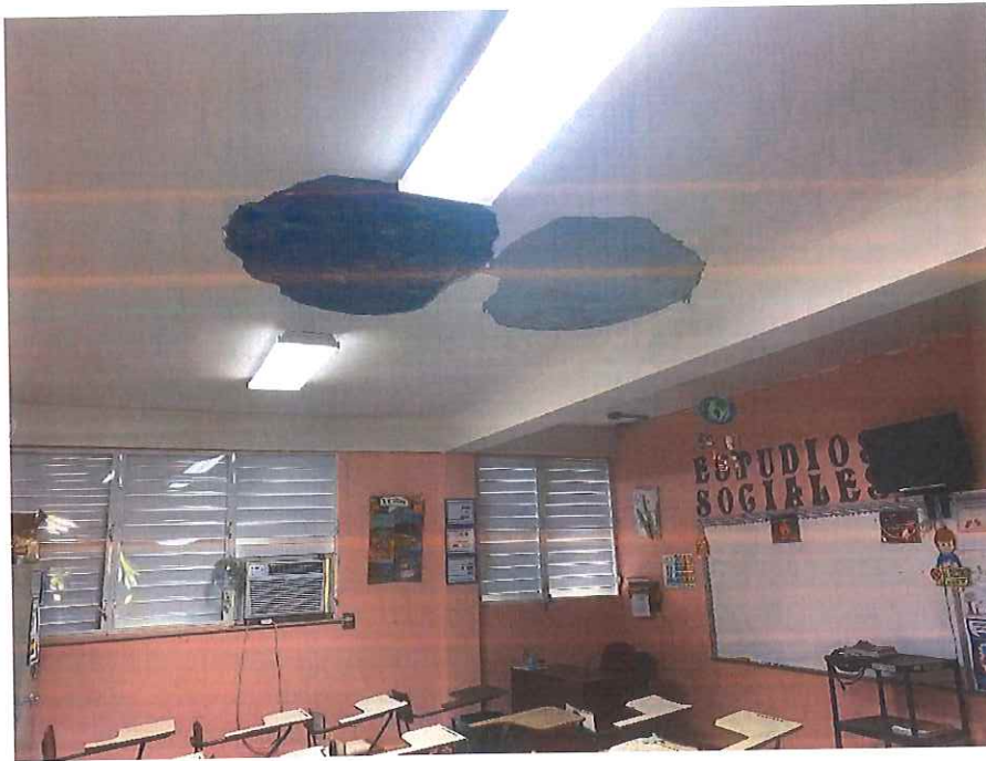
Foto 1: Salón #19 de Estudios Sociales localizado en el 2do piso del edificio #3, se desprendió parte del empañetado del plafón. Se observa que todavía hay parte del empañetado despegado que pudiera caer.
