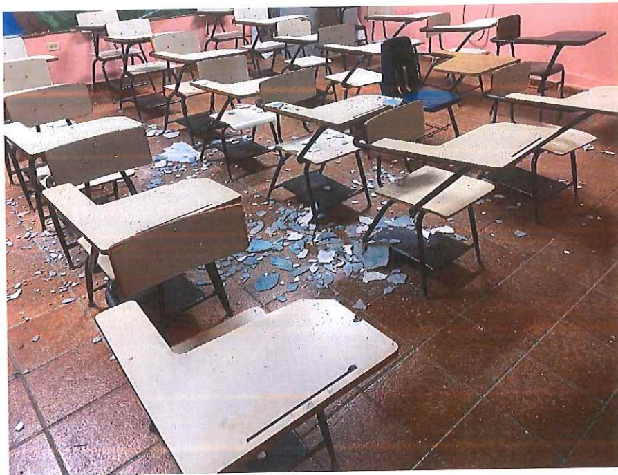
Foto 2: Salón #19 de Estudios Sociales localizado en el 2do piso del edificio #3, se desprendió parte del empañetado del plafón. Se observa que todavía hay parte del empañetado despegado que pudiera caer.
