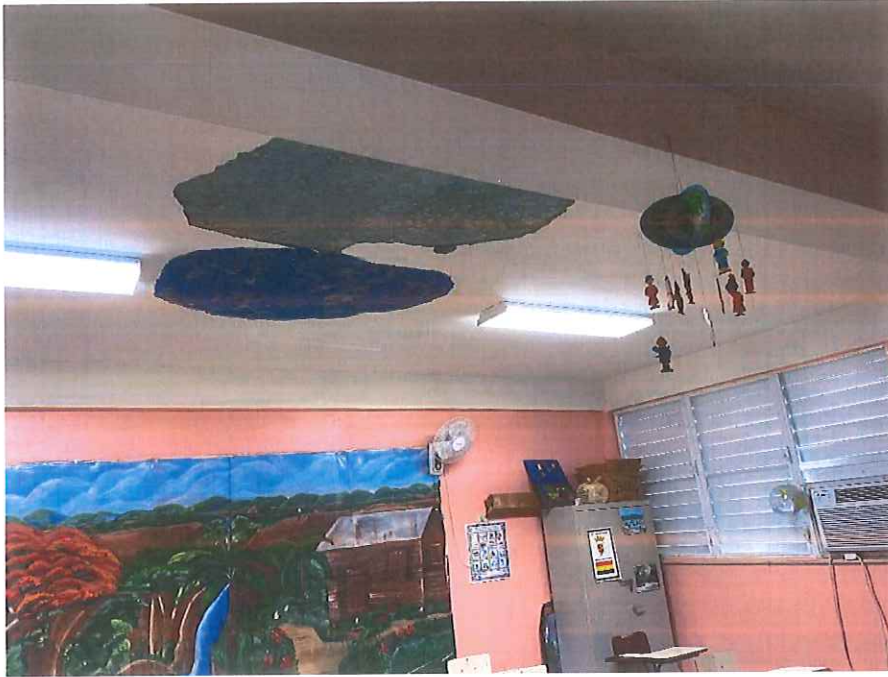
Foto 3: Salón #19 de Estudios Sociales localizado en el 2do piso del edificio #3, se desprendió parte del empañetado del plafón. Se observa que todavía hay parte del empañetado despegado que pudiera caer.
