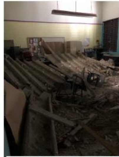
Ilustración 36. Colapso de techo en el tercer piso
