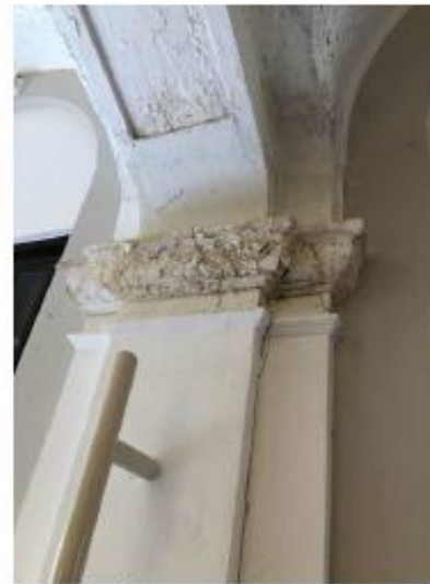
Ilustración 28. Filtraciones en el teatro
