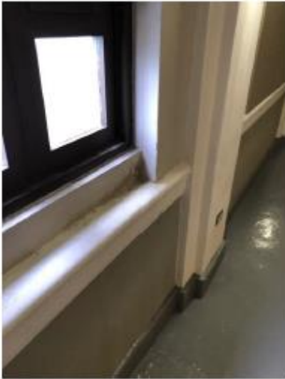
Ilustración 29. Filtraciones en el teatro
