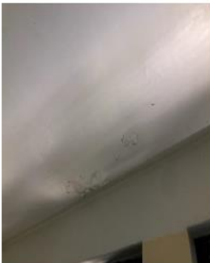
Ilustración 15. Filtración en plafón de madera acústico
