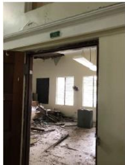
Ilustración 24. Techo del salón 312 colapso
