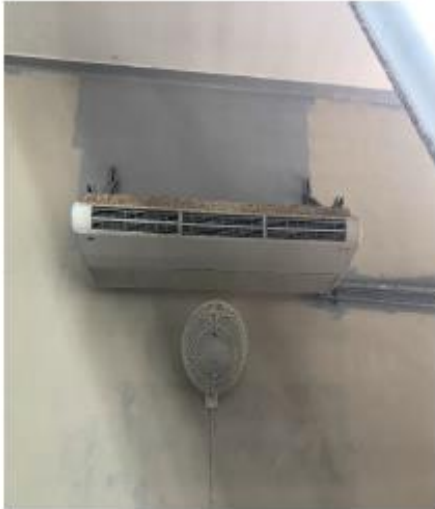
Ilustración 5. Aire de 5 tons. dañados
