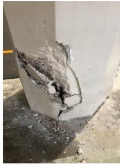
Ilustración 38. Columnas con grietas en la cancha
