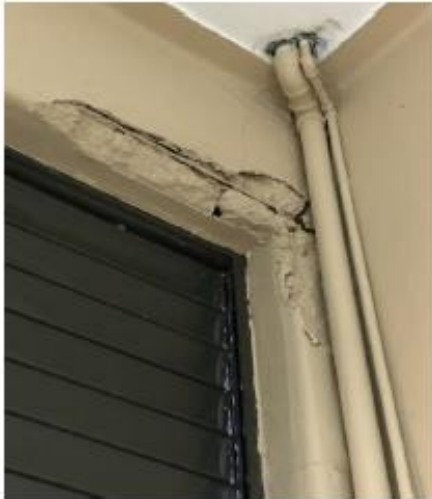
Ilustración 9. Empañetado de varilla expuesta salón 112
