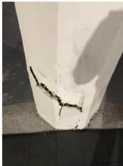
Ilustración 39. Columnas con grietas en la cancha
