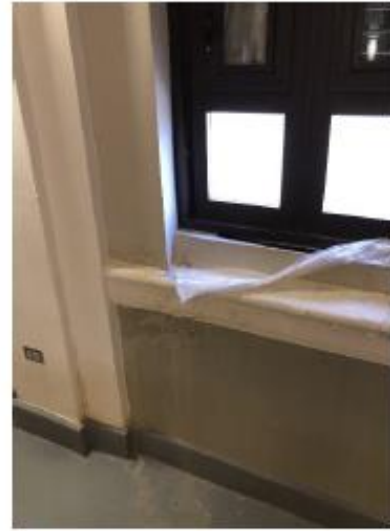
Ilustración 30. Filtraciones en el teatro
