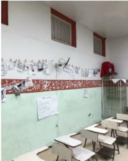
Ilustración 17. Falta de pintura
