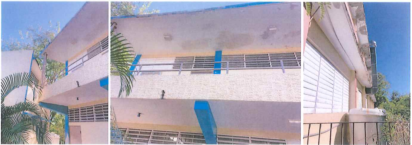
Fotos: Deflexión en techo pasillo del segundo piso
