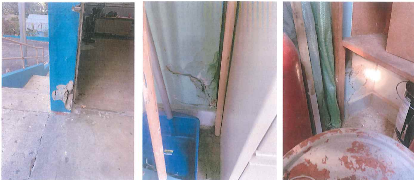
Fotos: Base de columnas en el primer piso deterioradas.
